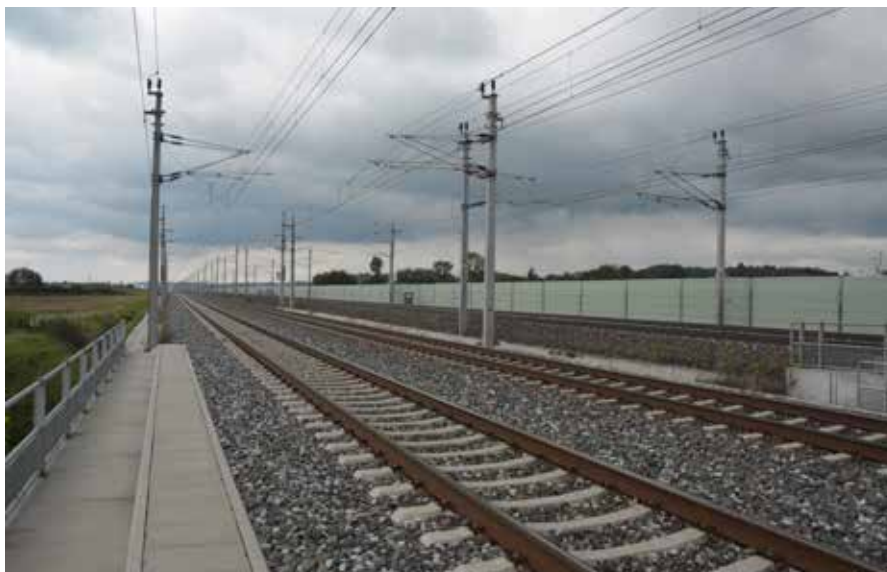
Bahn-Hochleistungsstrecken mit Lärmschutz als Totalbarriere für Tier und Mensch, hier der Abschnitt Amstetten – Blindenmarkt. (Foto: D. Leissing)
